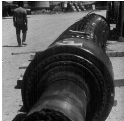
Hình 1.65. Roto bị sự cố khi đóng điện máy phát ở trạng thái nghỉ
